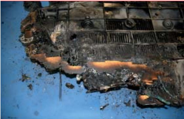
Bild 3: Blick von unten auf den Schadensschwerpunkt.
