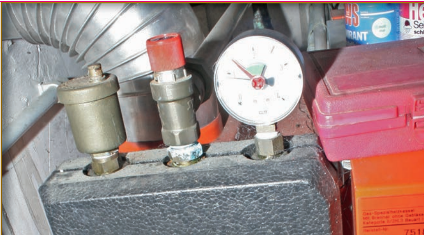
Bild 15 | Ein Sicherheitsventil mit einem Auslösedruck von 2,5 bar war lediglich an dem Gasheizkessel im Keller des Gebäudes angeschlossen.
