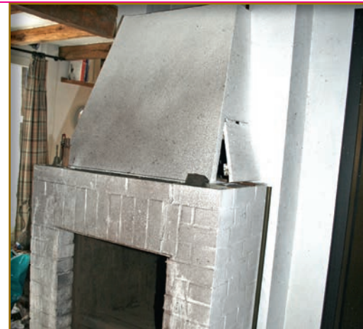
Bild 12 | Der wasserführende Kamin, von dem die Druckwelle ausging
