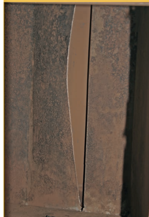
Bild 14 | Die feuerraumseitige Wand der Wassertasche ist aufgeissen.
