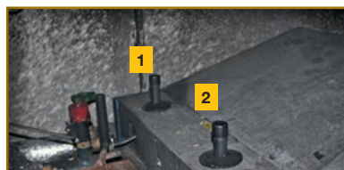
Bild 3 | Die Ziffern 1 und 2 kennzeichnen zwei nicht genutzte Anschlüsse.
