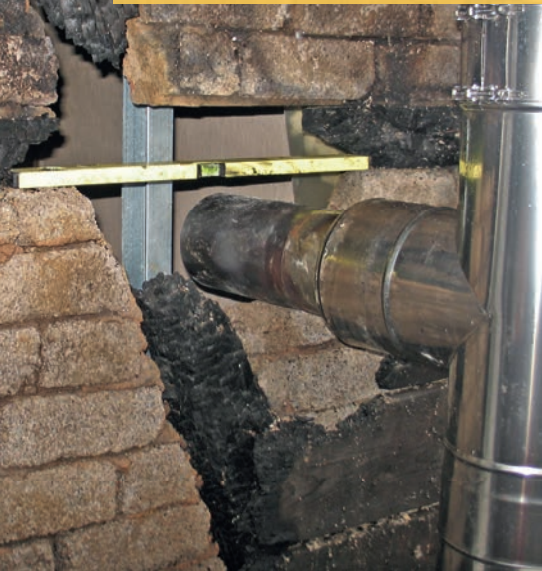
Bild 20 | Der Verlauf eines ehemals waagrecht, oberhalb des Verbindungsstückes verlaufenden Balkens wurde mit einem Abstand von etwa 3 cm zur Oberkante des Verbindungsstückes rekonstruiert.
