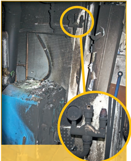
Bild 5 | Oberhalb der Regelung des Ölheizkessels ist eine Baugruppe u. a. mit dem Sicherheitsventil installiert. Steigt der Druck im Heizkreislauf aufgrund zu hoher Erwärmung, tritt hier an dem Sicherheitsventil Wasser aus. Dies ist an den hellen Fahnen an der Wand gut zu erkennen.
