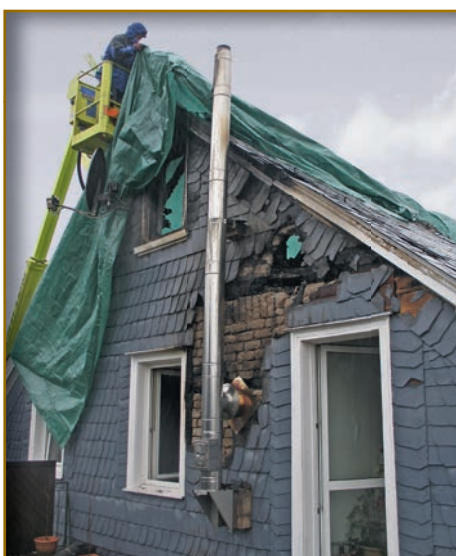
Bild 18 | Bei Brandentdeckung stellte man von der Dachterrasse aus ein Glutnest an der Gebäudeaußenwand im Bereich der Durchführung des Verbindungsstückes des Kaminofens fest.
