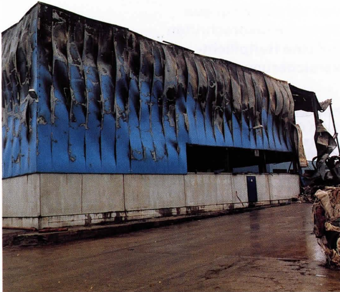
Abb. 1: Großbrand in einer Müllsortierungsanlage
