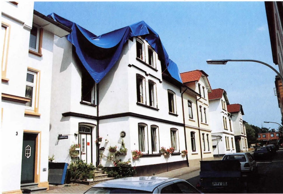
Abb. 8: Als schadenmindernde Maßnahme nach einem Wohnhausbrand wurde ein provisorisches Notdach errichtet
