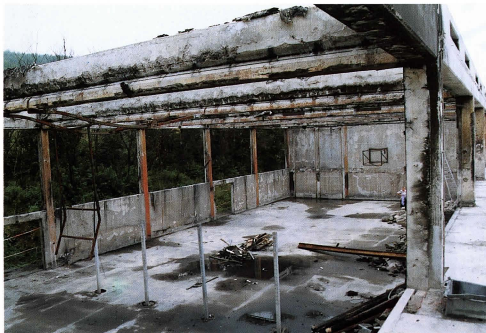
Abb. 9: Während nach dem Brand dieser Sporthalle aufgrund der thermischen Schäden die Träger entfernt werden mußten, konnten nach bauphysikalischer und chemischer Prüfung die Stützen erhalten werden
