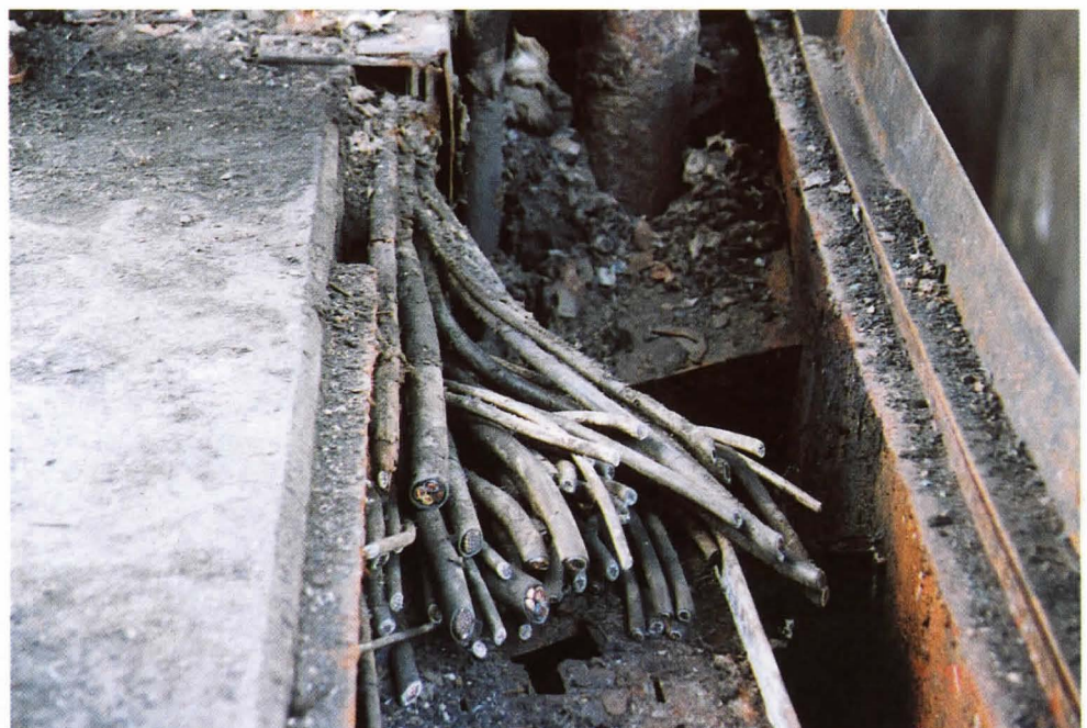
Abb. 7: Gebündelt verlegte Kabelstränge mit PVC- Ummantelung setzen im Brandfall große Mengen an korrosiven und toxi- schen Schadstoffen frei
