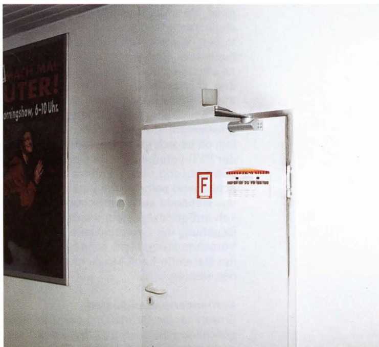
Abb. 5: Hinter der Tür brannte ein Tonstudio aus. Der Bereich außerhalb wurde optisch nur gering in Mitleidenschaft gezogen
