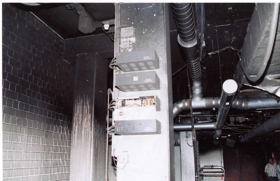
Abb. 6: Rauchgase kondensieren aufgrund der Thermik vornehmlich im Deckenbereich, wie es auch hier im Fall eines Kellerbrandes in einer Klinik deutlich zu sehen ist
