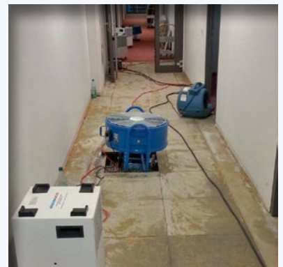
Bild 1 | Nach einem größeren Wasserschaden ziehen sich die Trocknungsarbeiten oft über Wochen hin, was neben dem Schadenaufwand auch zu einem Nutzungsausfall führt.
