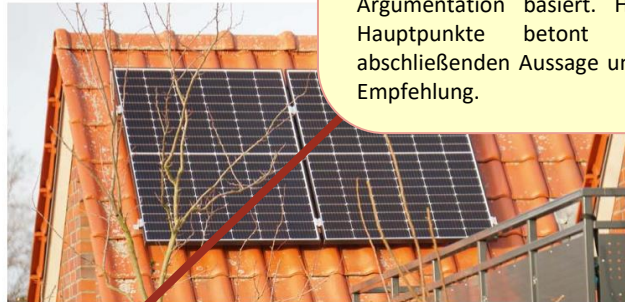
Bild 5 / Mini-PV-Anlage auf einem Satteldach
