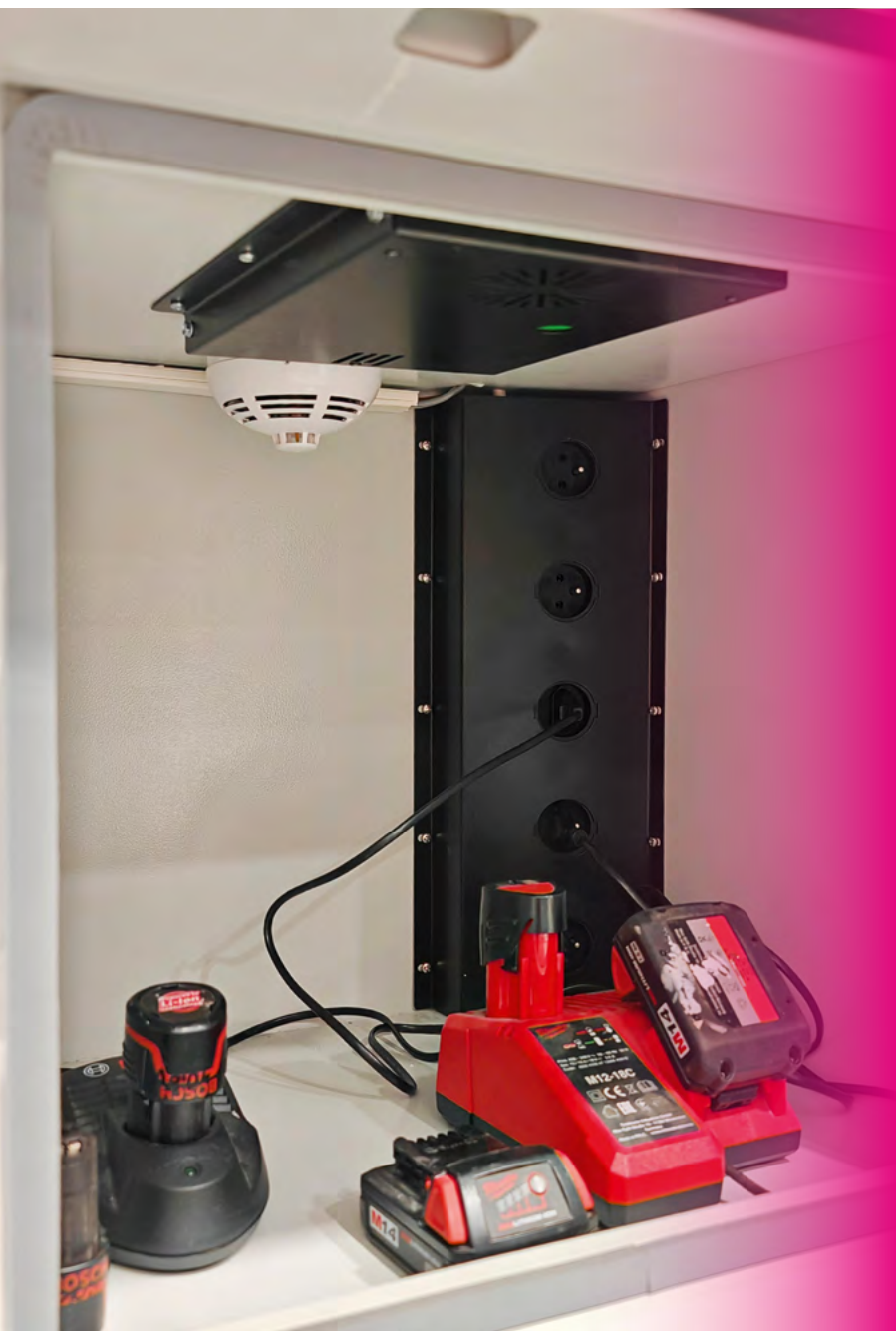
Bild 2 / Rauchmelder in einem Batterietresor
