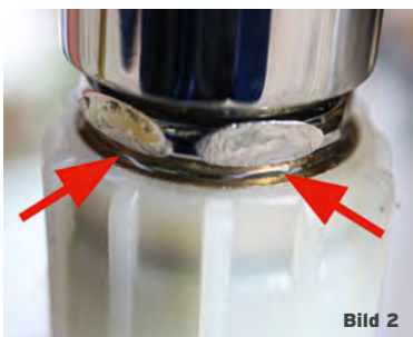
Bild 2 / Auch die im Labor nochmals erstellte Verbindung ist zwischen dem Überwurf und dem Rohrbelüfter leicht undicht (Pfeile).
