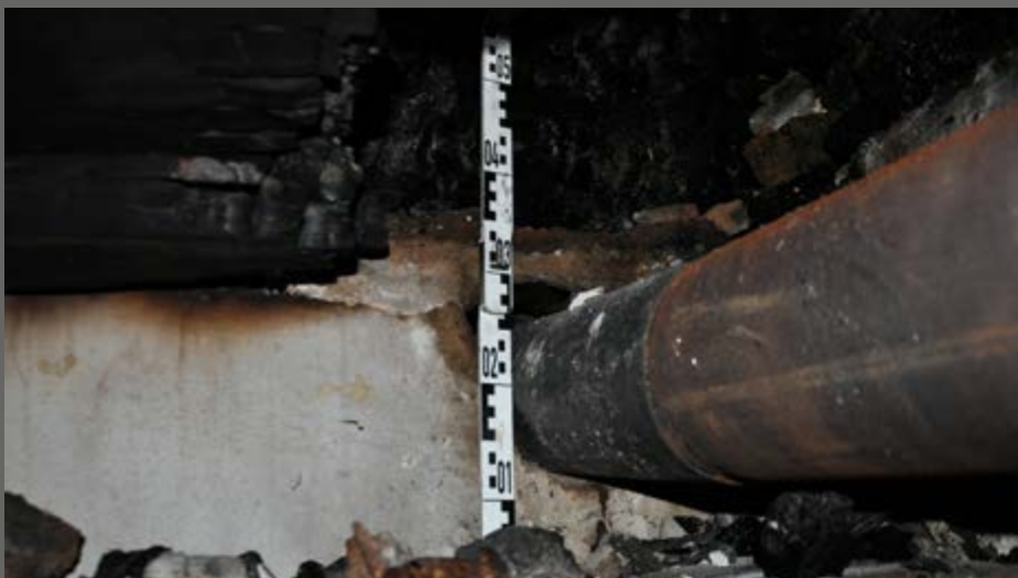
Bild 3 | Zwischen dem einwandigen Rohr und dem Holzbalken, der hier bereits weggebrannt ist, war kaum Platz.
