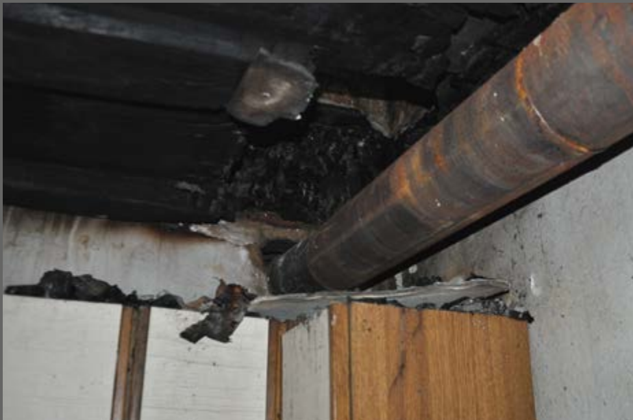
Bild 2 | Das Feuer entstand an einem Deckenbalken direkt vor dem Wanddurchbruch in der Küche.
