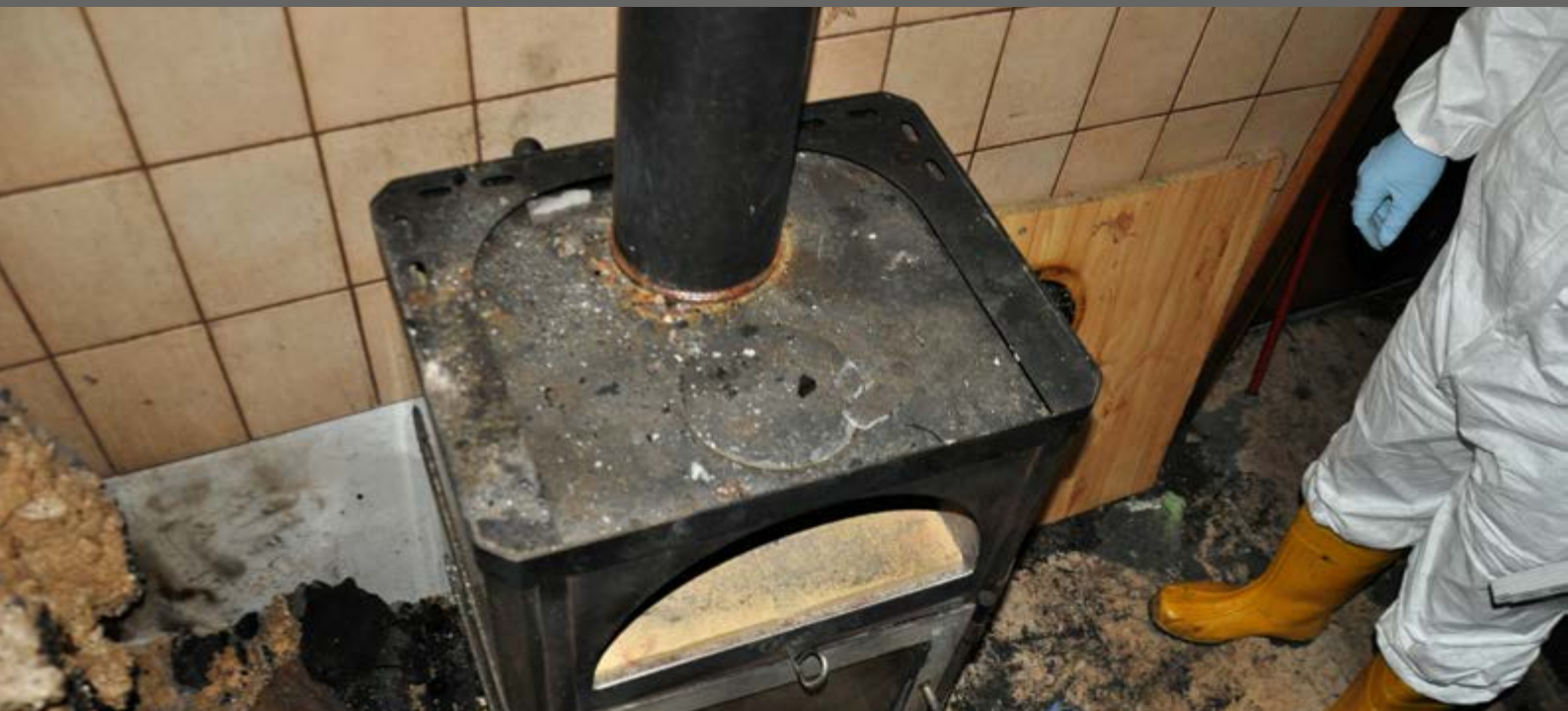
Bild 1 | Vom Schwedenofen verläuft das Abgasrohr zunächst senkrecht nach oben und später waagrecht unter der Decke.
