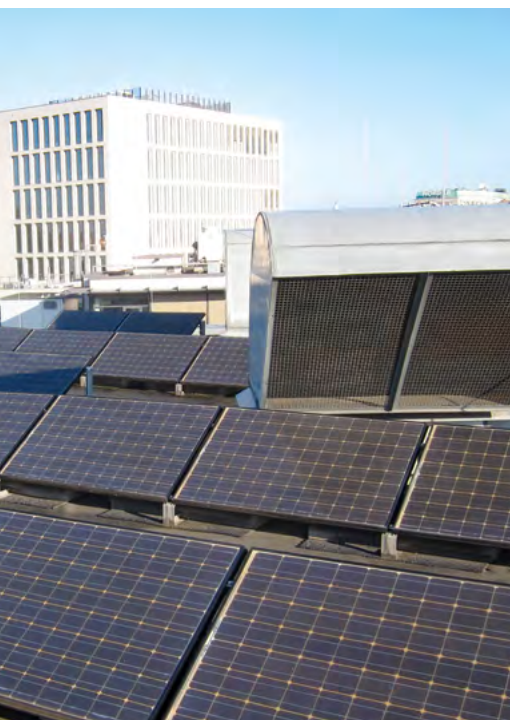
Bild 6 / PV-Anlage Bj. 2003 / 6,5 kWp
