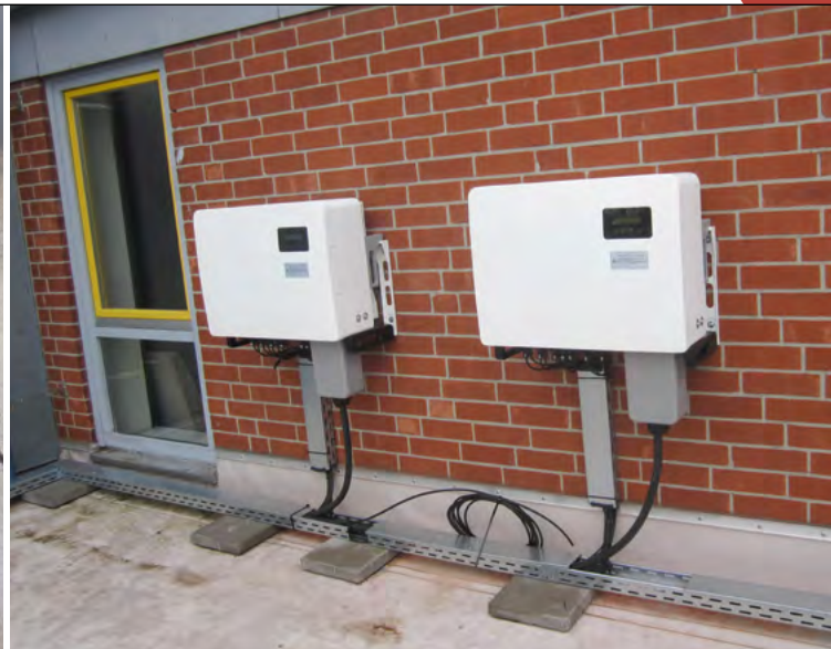
Bild 3 / Wechselrichter ungeschützt über einem brennbaren Dachaufbau
