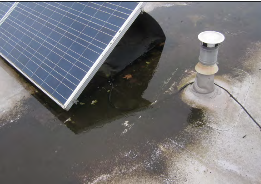
Bild 2 / Mangelhaft installierte DC-Leitung
