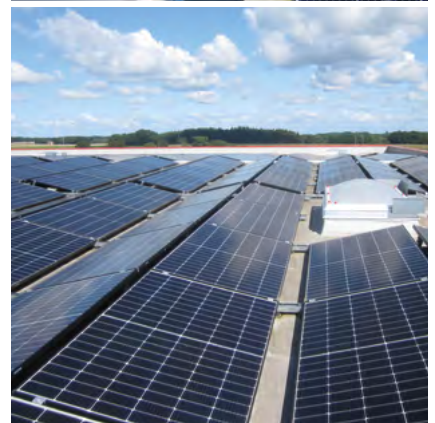
Bild 5a+5b / Abstände zu Rauch- und Wärmeabzugsanlagen zu gering
