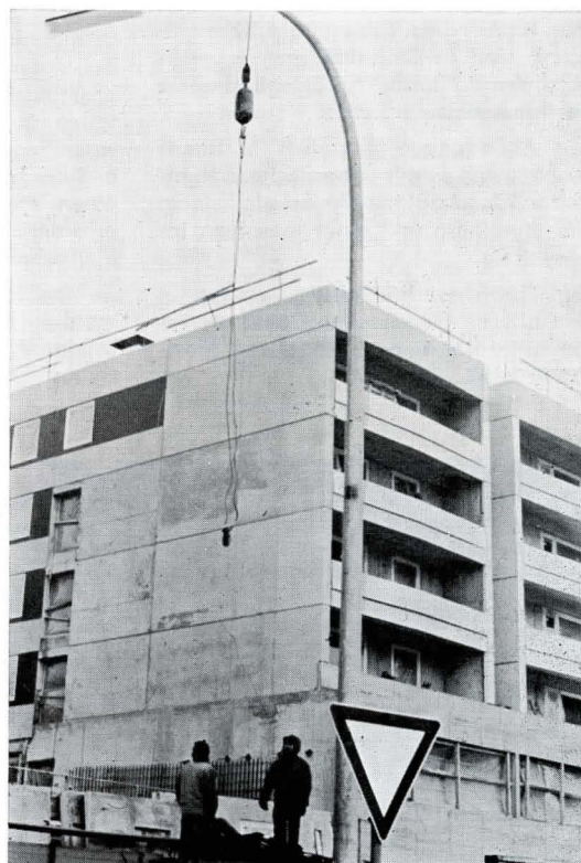
Bild 1. Das vom Schaden betroffene Gebude.
