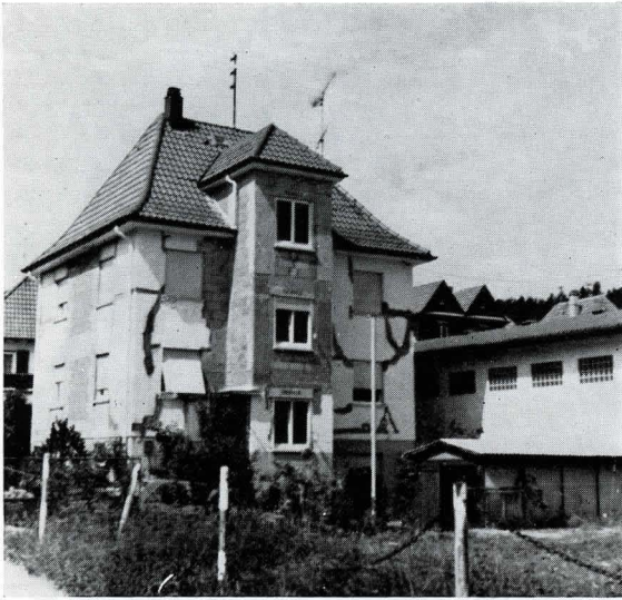
Bild 13. Bei geringeren Schäden wurden die Risse im Mauerwerk vernadelt und mit Mörtel, dem Epoxidharz zugesetzt war, wieder geschlossen.
