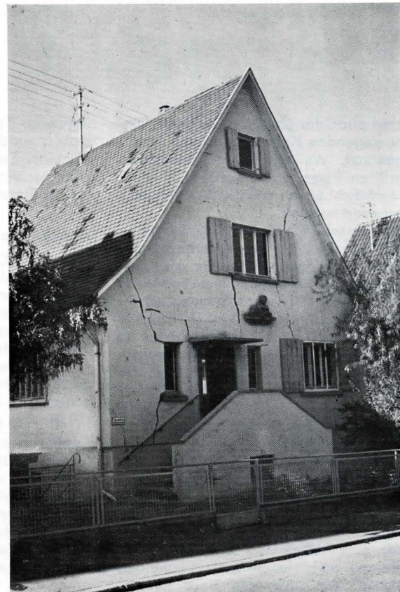
Bild 5. Schräge Schubrisse in den Wänden, die vor allem an den schwachen Stellen von Gebäuden aufgetreten sind (Fensterpfeiler).
