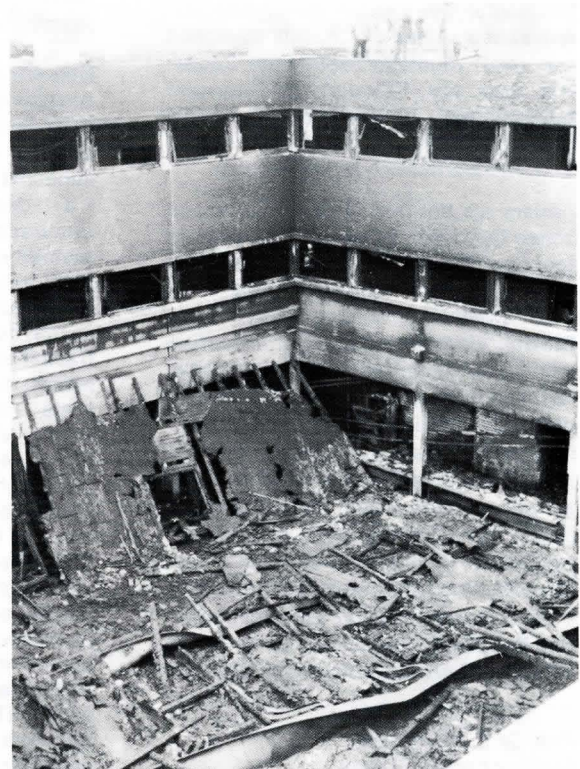
Bild 5. Großbrand in einer Schule – Feuerüberschlagswege in den eine Pausenhalle umgebenden Trakten.
