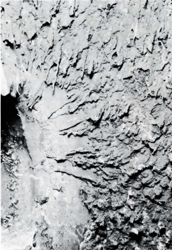
Bild 3. Korrosionserscheinungen in einem Kesselvorrauf- stutzen.
