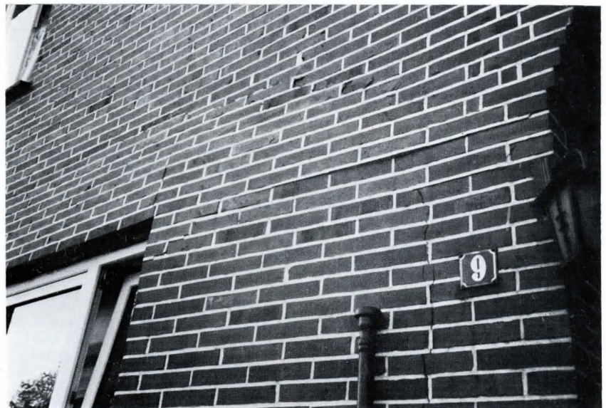
Risse und abgeplatzte Oberflächen vom Mauerwerk des Giebels. Rechts vom Fenster Ausbeulungen.
