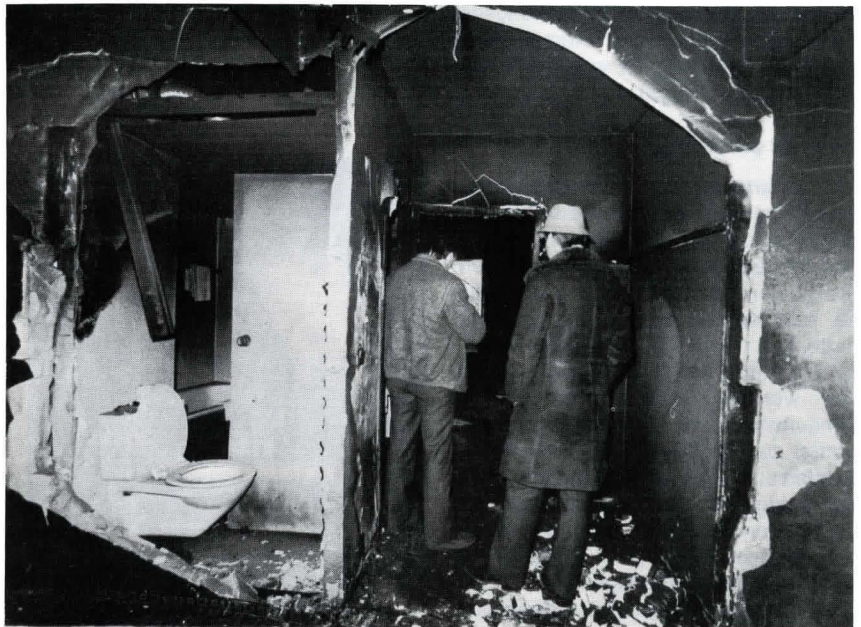
Bild 4. Von der Verpuffung zerstörte Zwischenwand zwischen Zimmer und Vorraum/Bad.
