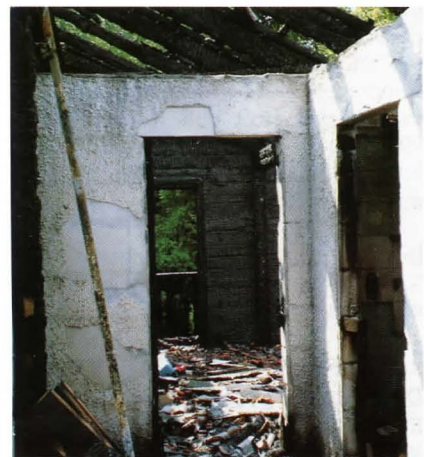
Bild 2 links: Blick in das ausgebaute Dachgeschoß. Blick vom Treppenhaus in das Kinderzimmer (mutmaßliche Einschlagstelle). Die tragenden Holzteile sind fast völlig abgebrannt. Die Bewohner blieben zum Glück unverletzt.
