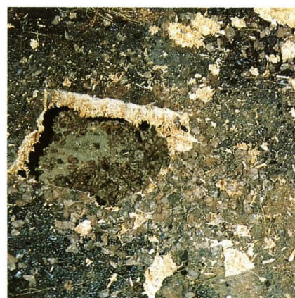
Bild 5: Als Fehlbodenschüttung wurde Korkgranulat verwendet. Diese Deckenkonstruktion ermöglichte eine relativ schnelle Brandausbreitung in das Erdgeschoß.
