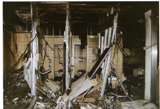
Bild 15: Der Explosionsbereich 1 vor dem Ausräumen. Die Sanitär-Räume wurden vollständig zerstört. Ein Waschbecken flog über 100 m weit durch das entgegengesetzt angeordnete Fenster und landete auf der Straße.
