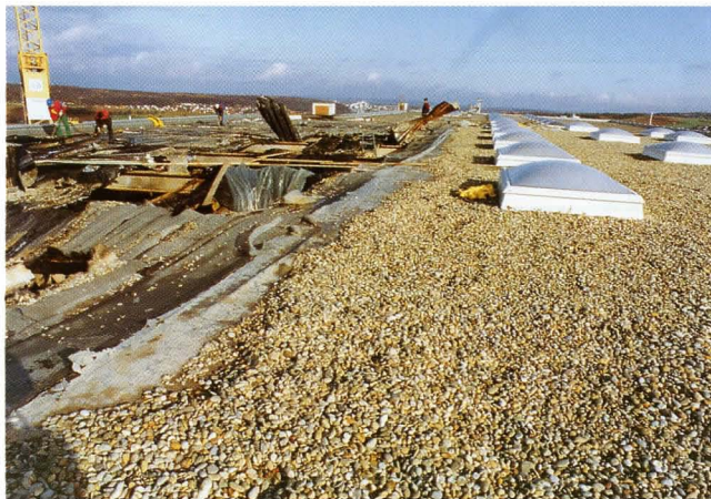
Bild 5: Situation aus Bild 4. Im Bereich der Trennwand wurde auf etwa 1 m Breite die Wärmedämmung nichtbrennbar aus Mineralfaser ausgeführt.
