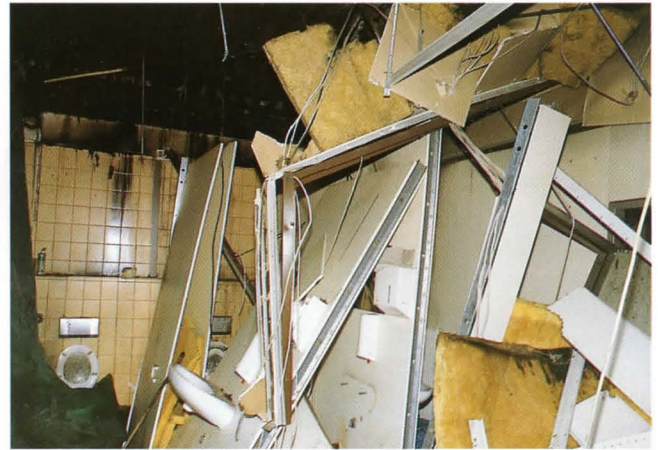
Bild 19: Explosionsbereich 2. Ansicht von Süden in Richtung Trennwand. Die Trennwand wurde durch die flüssigen Zersetzungsprodukte in den Tiefsicken überlaufen, was deutlich an den Laufspuren zu sehen ist.
