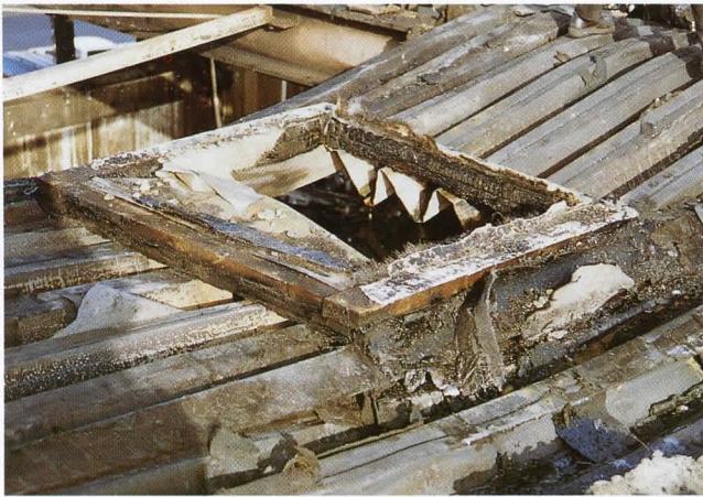
Bild 12: Ergänzung zu den Bildern 10 und 11. Auch über die Anschlüsse der Trapezbleche an den Lichtkuppeln konnten die Pyrolyse-gase in den Deckenhohl- bzw. Brandraum eindringen.
