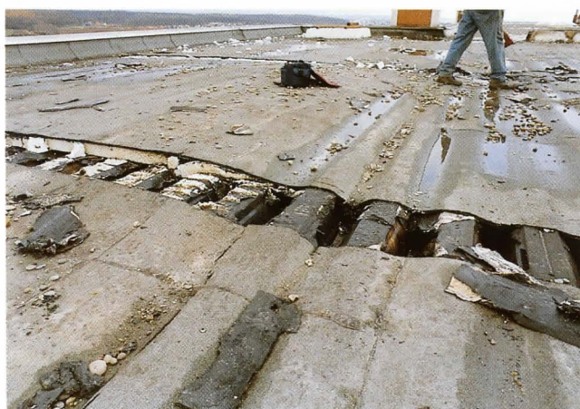
Bild 7: Dachaufbau und fortschreitender Zersetzungsprozeß. Links in Richtung Dachrand keine größere thermische Beanspruchung. Rechts in Richtung Brandausbruchsbereich große Hitze einwirkung. Die Polystyrol-Hartschaumplatten wurden aufgelöst, die Abdichtung blieb bestehen.
