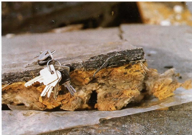
Bild 6: Detail aus dem Bild 5. Das „Abdichtungs-Paket“ hatte zum Teil eine Dicke von mehr als einem Zentimeter.
