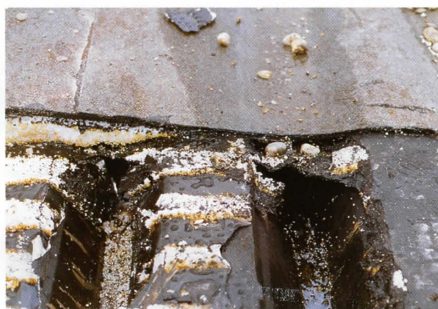
Bild 8: Detail aus Bild 7. Die Zersetzungprodukte verteilten sich in den Tiefsicken in Gebäudelängsrichtung.
