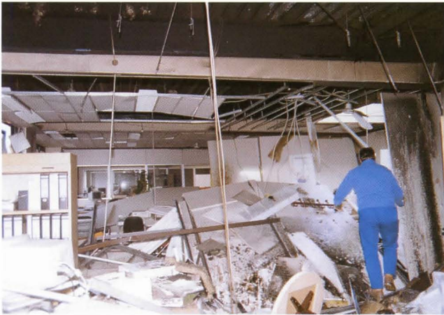
Bild 18: Der Explosionsbereich 2. Ansicht von der Trennwand in Richtung Norden. Die leichten Trennwände sowie die untergehängten Decken wurden in diesem Bereich zerstört bzw. eingedrückt.
