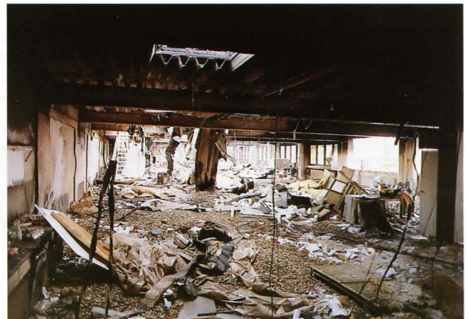
Bild 25: Die zerstörte Halle. Hinten links (Leiter) ist der Brand ausgebrochen. Deutlich ist die unterschiedliche Beanspruchung der Stahlträger zu sehen. (Anlauffarben bzw. Verrußung).
