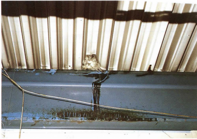
Bild 22: Ausstopfungen aus loser Mineralfaser können die Ausbreitung von Gasen und flüssigen Zersetzungsprodukten nicht verhindern. Die Aufnahmen entstanden ca. 20 m nördlich von der Trennwand entfernt im Deckenhohlraum.
