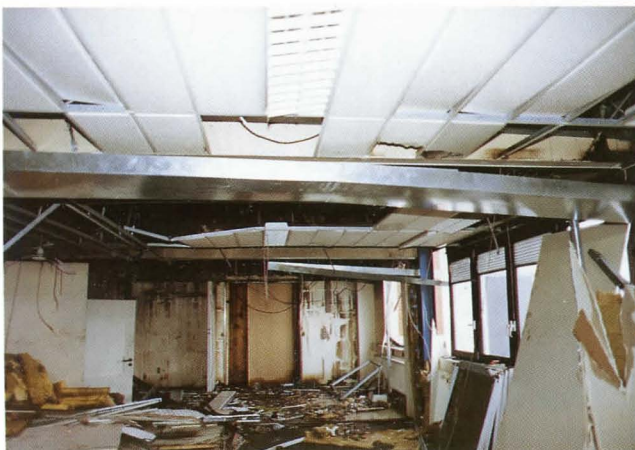
Bild 20: Explosionsbereich 2. Blick aus Norden zur Trennwand. Die Feuerschutztür wurde durch die Explosion aus der Wand herausgerissen. Deutlich zu sehen auch die untergehängte Decke mit dem zerstörten Deckenbereich.
