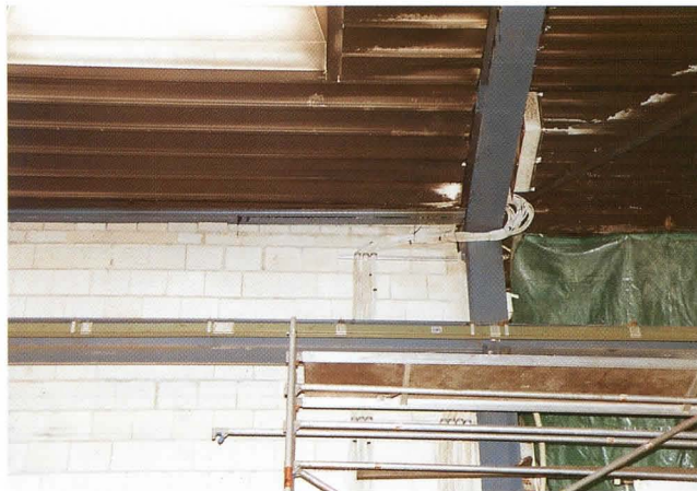
Bild 24: Detail aus Bild 23. Die Längstrennwand aus 2 x 24 cm Kalksandsteinmauerwerk war ebenfalls nicht über Dach geführt worden.
