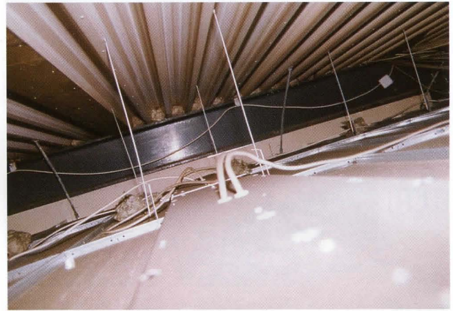
Bild 13: Unterhängte Decke aus nichtbrennbaren Platten und Trapezblechdach im nicht beschädigten Bereich. Im Hintergrund sind die Ausstopfungen der Sicken im Bereich von leichten Trennwänden (Halle mit medizinischen Geräten) zu sehen.
