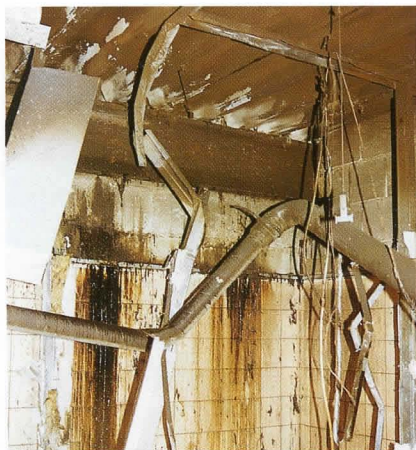
Bild 14: Das Gasgemisch verteilte sich sowohl in den Sicken als auch im Deckenhohlraum. Schließlich gelangte es zum dargestellten Explosionsbereich 1, erreichte eine zündfähige Konzentration und es kam zur ersten Explosion. An den Ablaufspuren ist deutlich zu sehen, daß auch flüssige Schmelzprodukte über die Tiefsicken bis hierher gelangen konnten.
