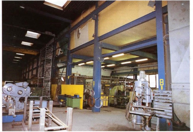
Bild 23: Ansicht von Norden. Der metallverarbeitende Betrieb. Im oberen Bereich leichte Trennwand (beidseitig doppelt beplankt) zur nördlichen Halle (Medizinische Geräte). Im Bereich der Plane wurde die leichte Trennwand zum Teil beschädigt, so daß hier Rauch eindringen konnte. Das Loch in der Trennwand (ein Feld davor) wurde durch die Feuerwehr gebrochen.
