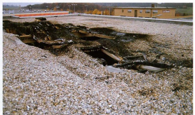
Bild 4: Dach oberhalb des Brandausbruchbereiches von Nord-Ost aus gesehen.
