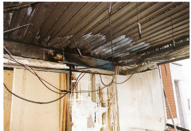
Bild 21: Detail aus Bild 20. Thermische Beanspruchung der Trapezblechunterseiten (Deckenhohlraumbereich).
