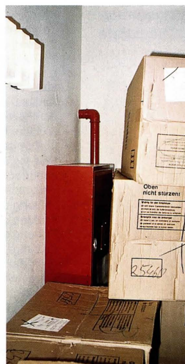
Dieser Wandhydrant ist im Ernstfall nicht zu nutzen
