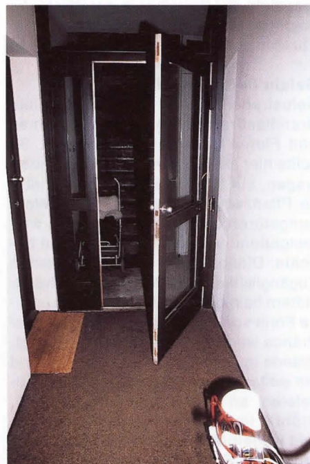
So nicht! – Offene Rauchschutztür, verstellter Treppenraum – ein Angebot für Brandstifter
