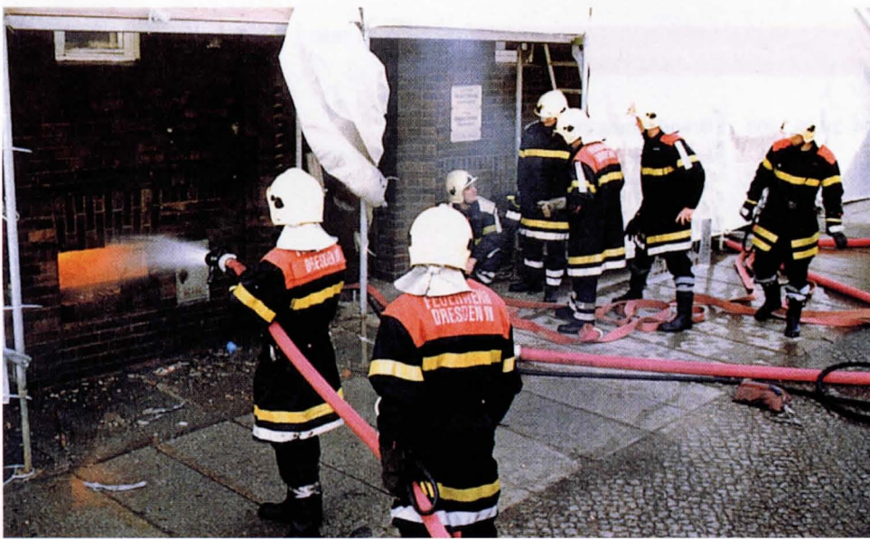
Die Feuerwehr legt Hand an – Handschachtung an der Außenwand zum Freilegen der Hausanschlußleitung
