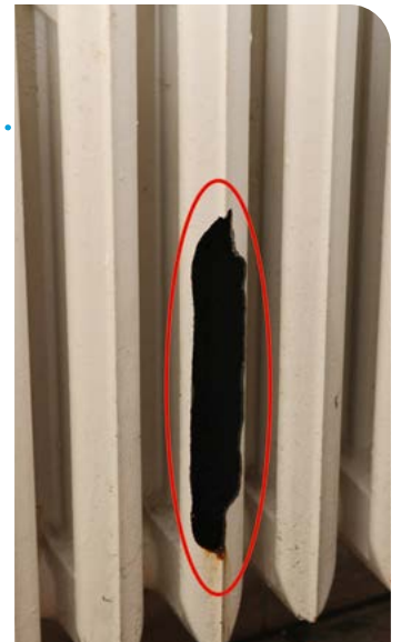
Bild 5 / Der Gussheizkörper platzte infolge des Überdrucks durch eine Frosteinwirkung auf.
