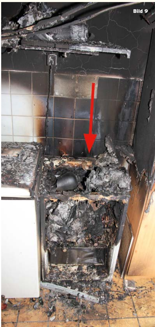
Bild 9 / Die Brandstelle im Keller mit dem stark brandbetroffenen Kühlschrank (Pfeil)
