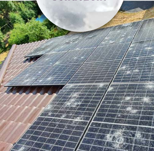
Bild 1 / Hagelschäden an PV-Modulen (Quelle: EPZ)
