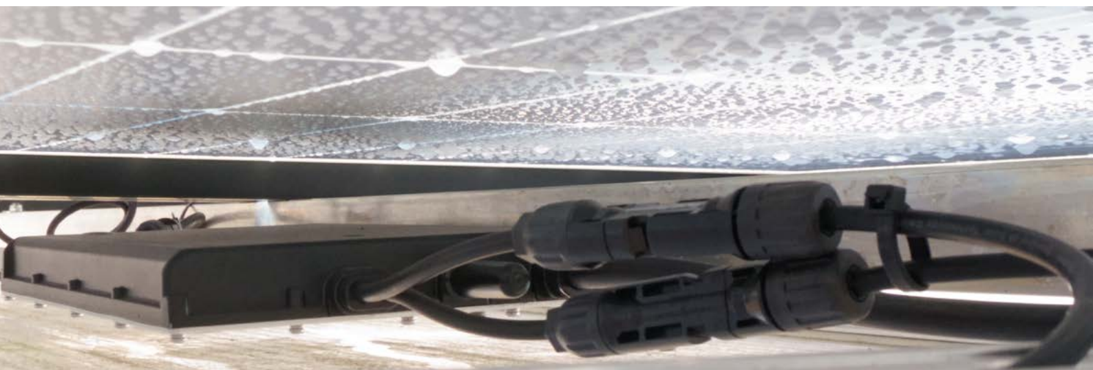
Bild 3 / Micro-Wechselrichter unterhalb der PV-Module
