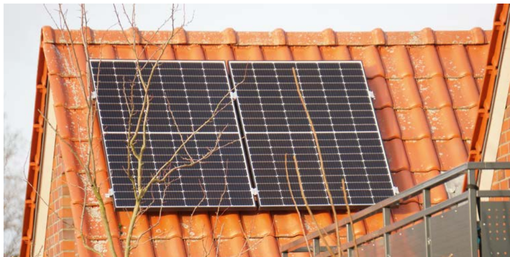
Bild 5 / Mini-PV-Anlage auf einem Satteldach
