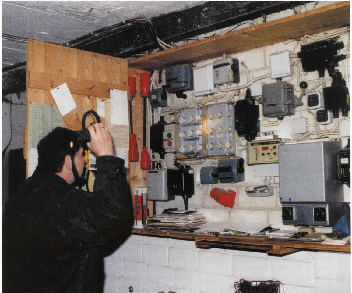
Defekte oder nicht ordnungsgemäß errichtete elektrische Anlagen sind nach der Brandstiftung die häufigsten Brandursachen auf landwirtschaftlichen Betrieben. Vorbeugende Maßnahmen sollen hier Abhilfe schaffen.
