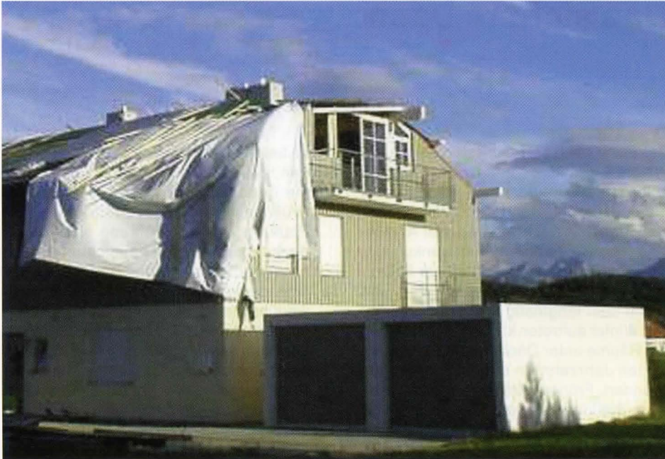
Bild 2: Am 3. August 2001 zog nach einer Hitzewelle eine Gewitterfront durch Südbayern. Binnen weniger Stunden entstand im Alpenvorland eine Schneise der Verwüstung. Hunderte Dächer wurden teilweise schwer beschädigt. Die Aufnahme entstand bei Rosenheim in Oberbayern.
