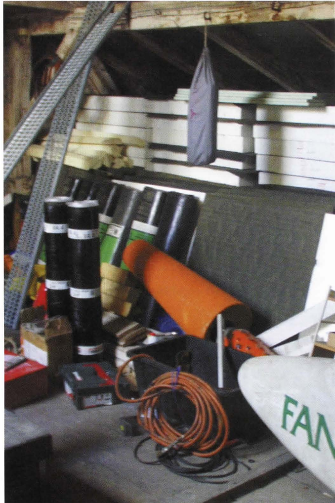
Bild 4: Unsachgemäße Lagerung übergroßer Mengen an Baumaterialien auf dem zu sanierenden Dachboden
