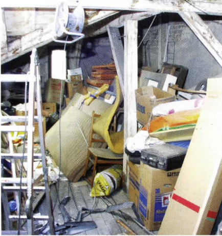
Bild 3: Brandgefährliche Unordnung im gesamten Dachbodenbereich
