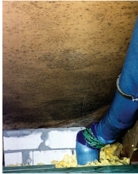
Bild 3: Stark befallene Holzfaserplatte hinter einer Wärmedämmung ohne Dampfsperre.
