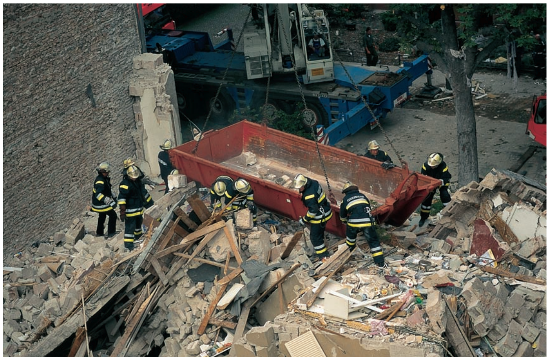
Bild 2: Praktiziert und bewährt! – Einsatz von Kran-technik einer Privat-firma bei einem Großeinsatz der Feuerwehr
