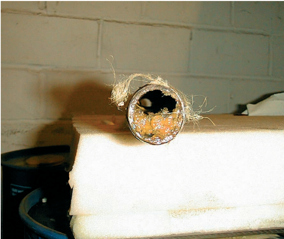
Bild 2: Hauptleitung einer Nassanlage
