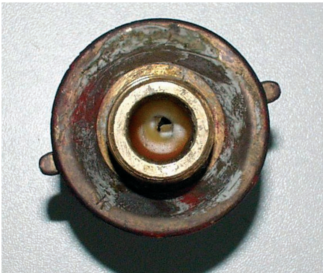
Bild 3: Rückstände im Durchlass eines 25 Jahre alten Sprinklers
