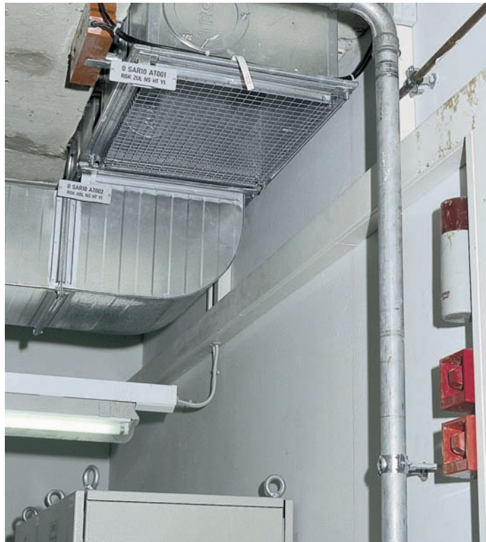
Bild 6: Brandschutzklappe im Lüftungsschacht
