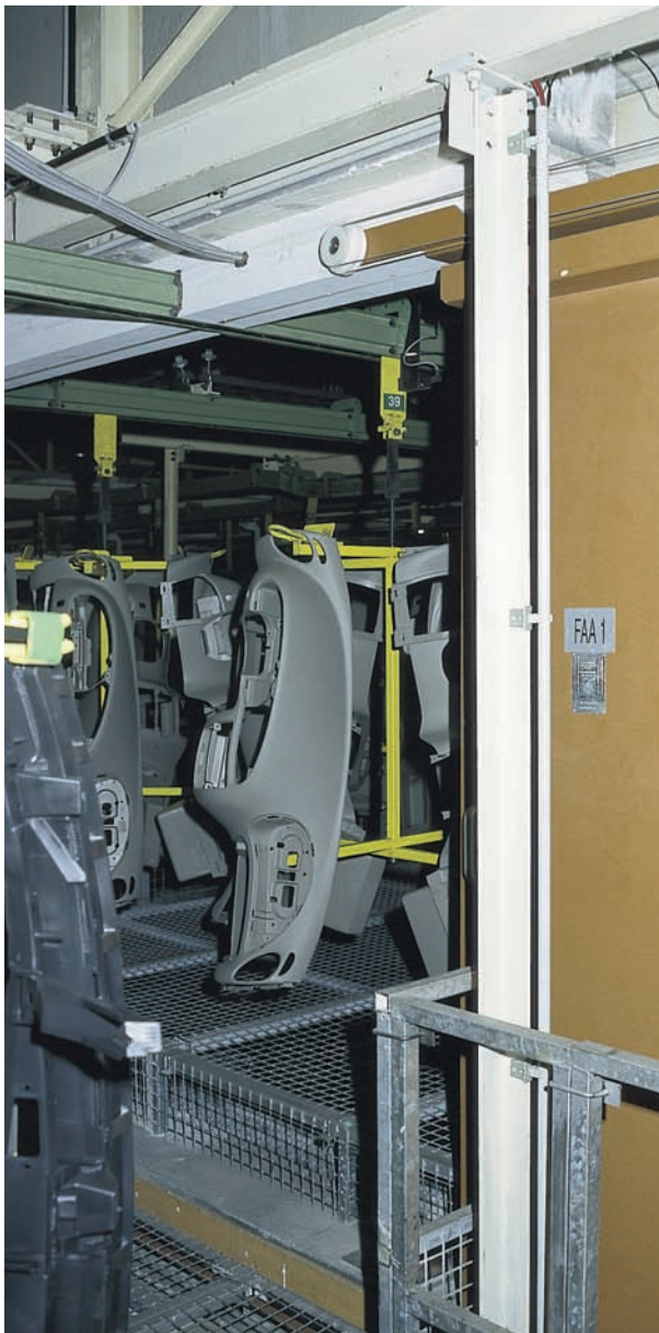
Bild 1: Brandschutztor in einer Produktionshalle für Automobilkunststoffteile
