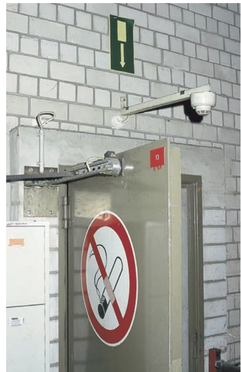
Bild 5: Brandschutztür mit zugelassener Feststell-einrichtung, die Auslösung erfolgt per Handtaster oder Rauchmelder
