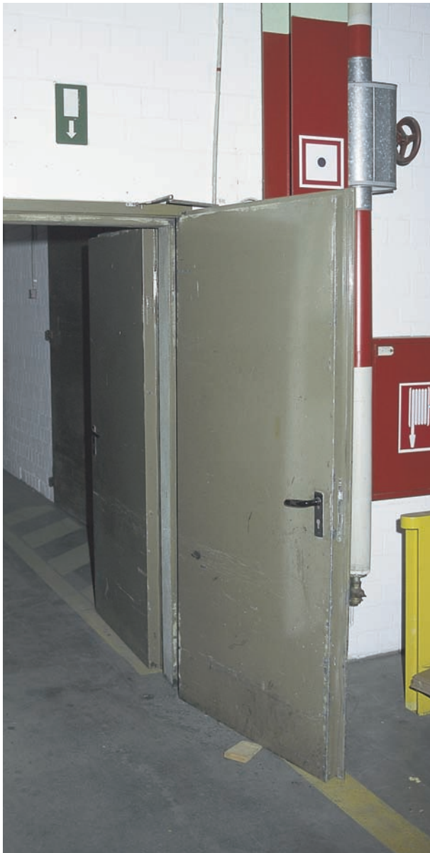
Bild 4: Keil unter einer Brandschutztür – nur regelmäßige Kontrollen können hier Schlimmeres verhindern
