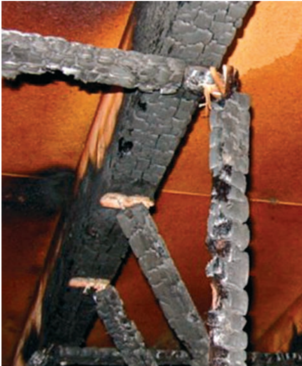
Abb. 4: Wohnzimmer nach Raumbrand b) Decke – GKP und Lattung sind vollständig zerstört, Dämmung wurde durch Feuerwehr entfernt, Durch- feuchtung der Spanplatte durch Löschwasser
