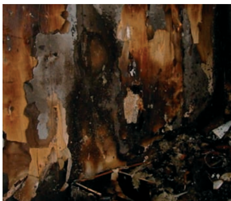
Abb. 4: Wohnzimmer nach Raumbrand a) Innenwand – GKP sind großflächig abgefallen, mittlere Brandzehrung an darunter liegenden Sperrholzplatten
