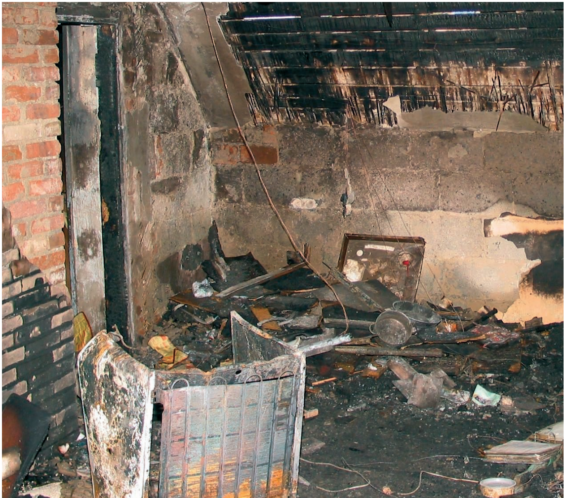
Abb. 1: Dieses Bild bot sich dem Brandursachenermittler am Schadenort nach dem Fettbrand in einer Küche
