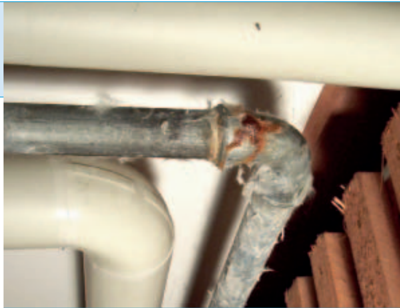
Bild 1: Korrosionsschäden an Trinkwasserrohren aus verzinktem Stahl.
