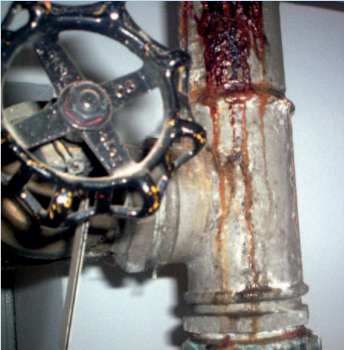
Bild 2: Korrosionsschäden an Trinkwasserrohren.
