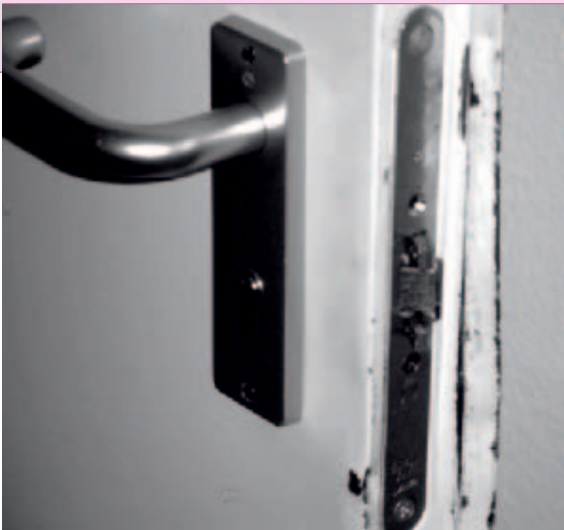
Bild 3: Aufgehebelte Kellertür (Brandschutztür).
