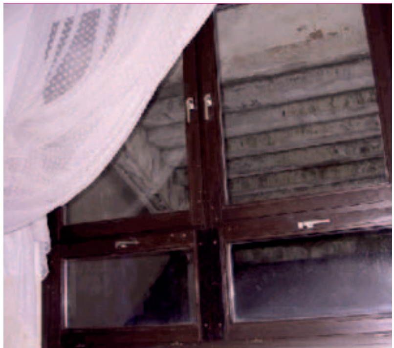
Bild 1: Von außen schwer einsehbares und ungesichertes Kellerfenster unter der Treppe.
