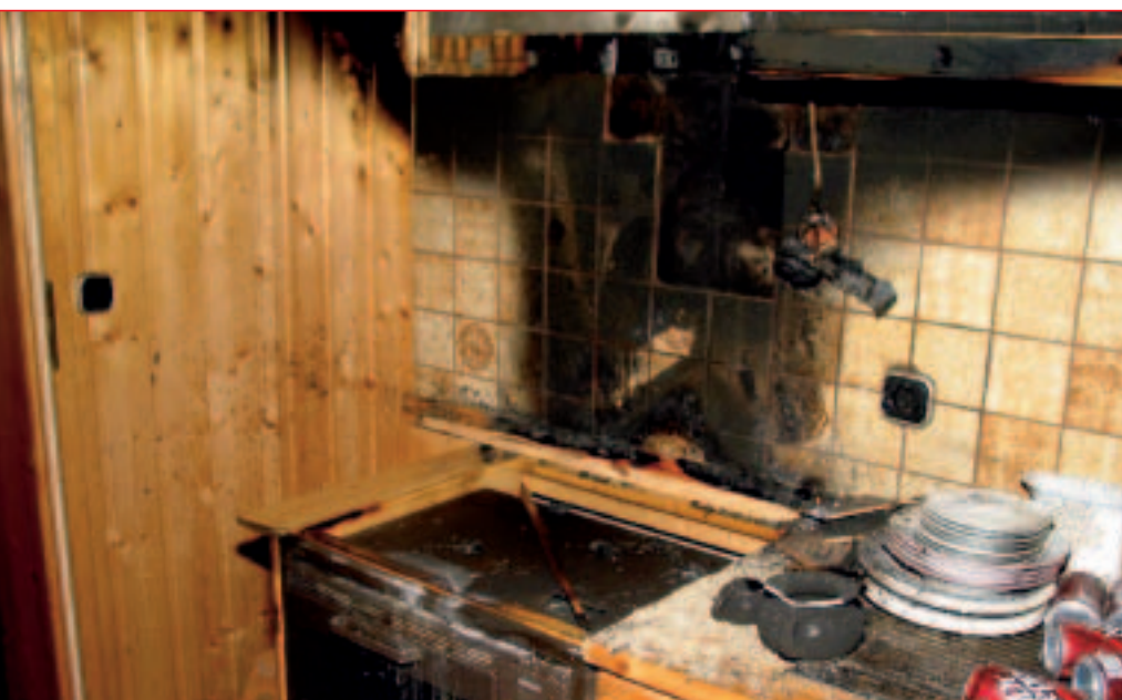
Bild 1: Blick auf den Brandausbruchsort
