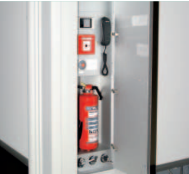
Bild 1: Alarmierungspunkt für das Aufsichtspersonal hinter einer Türöffnung mit Telefon, Feuermelder, Feuerlöscher etc.
