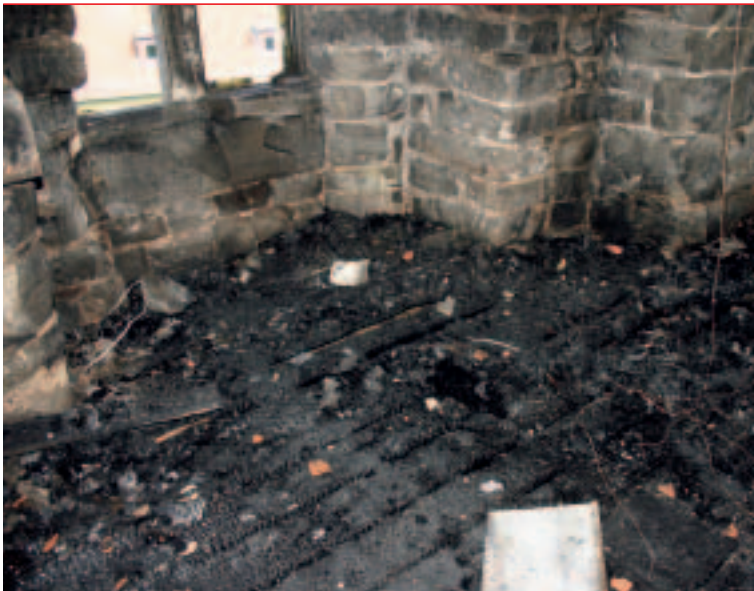
Bild 2: Der Brandschwerpunkt in der Fensternische.
