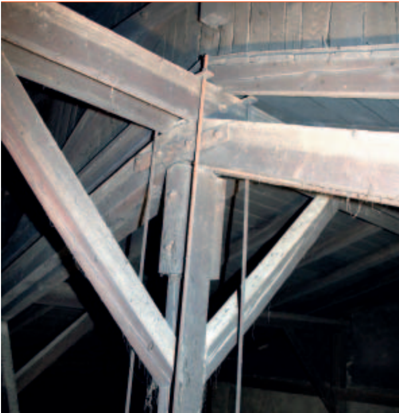
Bild 5 und 6: Holzfachwerkbinder – wegen erheblicher konstruktiver Mängel einsturzgefährdet (Schneedruckschaden wegen konstruktiver Mängel).
