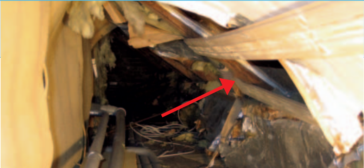
Bild 11: Unbeheizte Abseite mit wasserführenden Rohrleitungen, die Wärmedämmung zum Dach ist lückenhaft. Bei Frost konnten die Rohre einfrieren.
