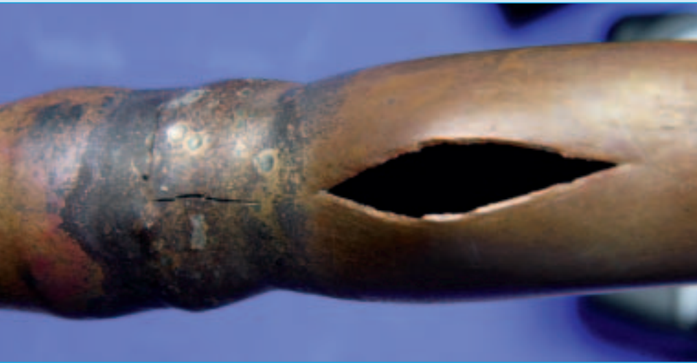
Bild 1: Hartgelötetes Kupferrohr, unter Frosteinwirkung gedehnt und aufgerissen.
