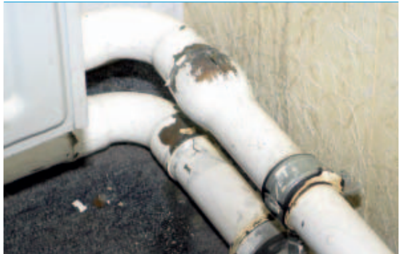
Bild 8: Gelöste Kupferrohre blähen sich unter gleichen Bedingungen zunächst umlaufend auf und reißen dann an einer Stelle auf.
