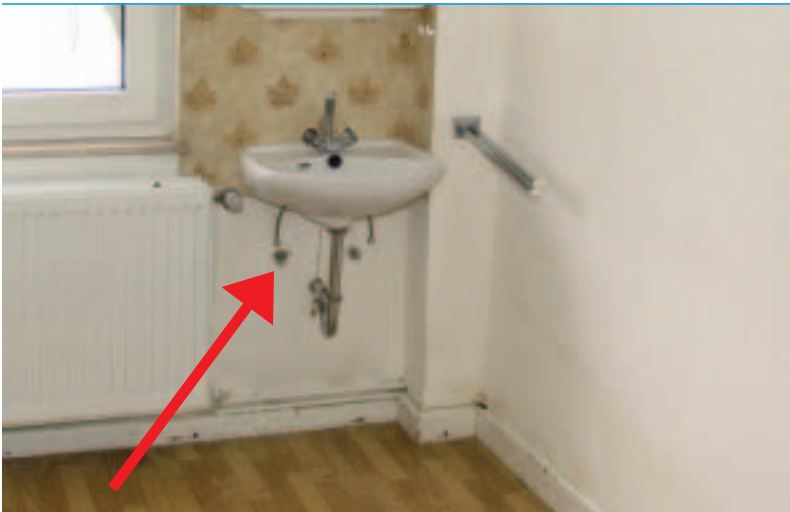
Bild 10: Die Zuleitungen des Waschtisches verlaufen in der Außenwand. Bei Frosteinwirkung wurde das Anschlussrohr zum Wasserhahn aus dem Eckventil gedrückt und Wasser trat aus.
