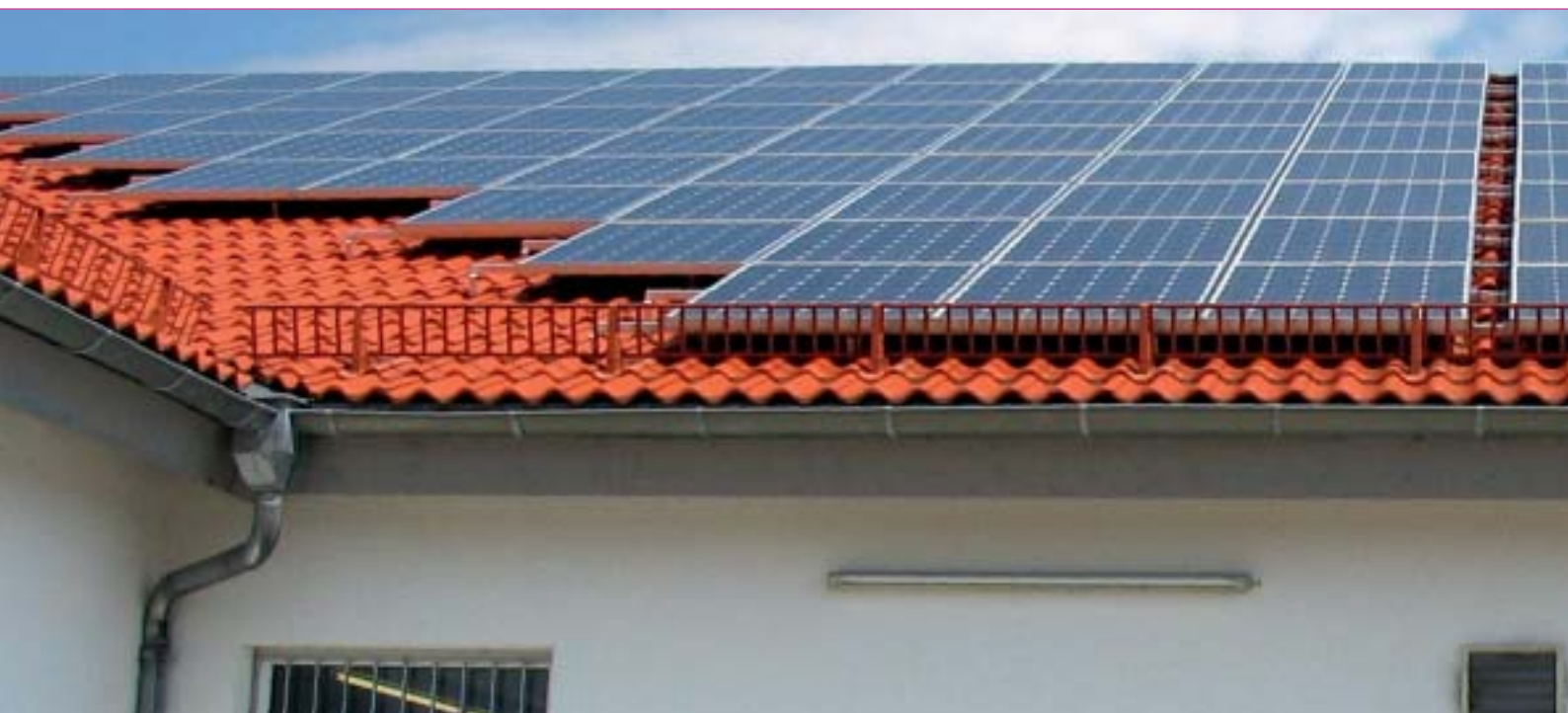
Bild 1: Immer öfter das „Objekt der Begierde“ bei Kriminellen – Solarmodule.
