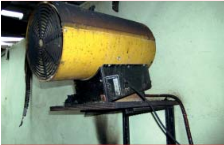
Bild 2: Der zweite Heizlüfter steht noch auf der Konsole
