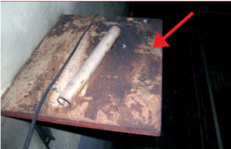
Bild 3: Die Konsole des anderen Heizlüfters; der Pfeil deutet auf den Abdruck eines vorderen Aufstellfußes
