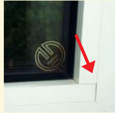
Bild 7: Transiente Überspannung – Zerstörte Alarmscheibe mit Schmauchspuren
