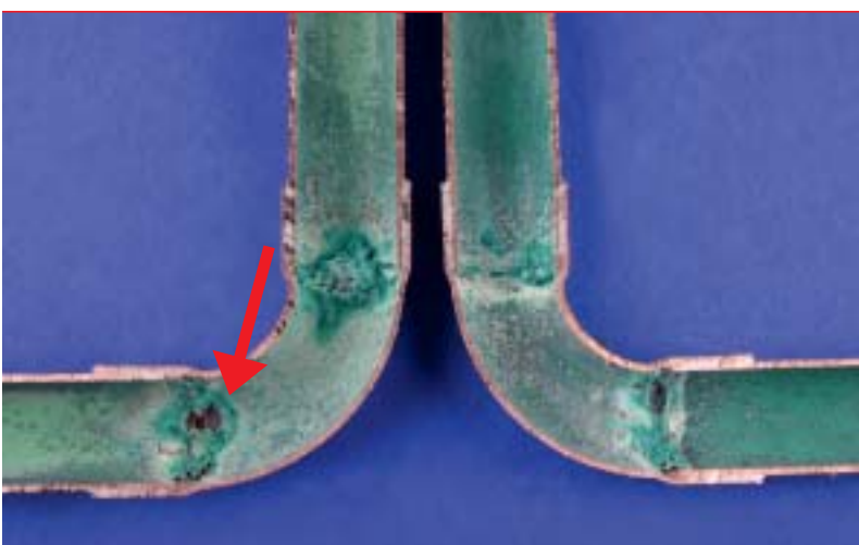
Bild 3: ... werden aufgetrennt. Die Markierung deutet auf einen Wanddurchbruch.
