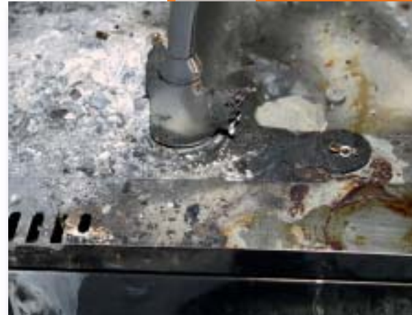
Bild 2 | Am Gehäuse der Mischbatterie sind die Spuren einer starken thermischen Einwirkung deutlich zu erkennen. Die Griffstücke der Ventile sind weitgehend abgeschmolzen bzw. verbrannt.
