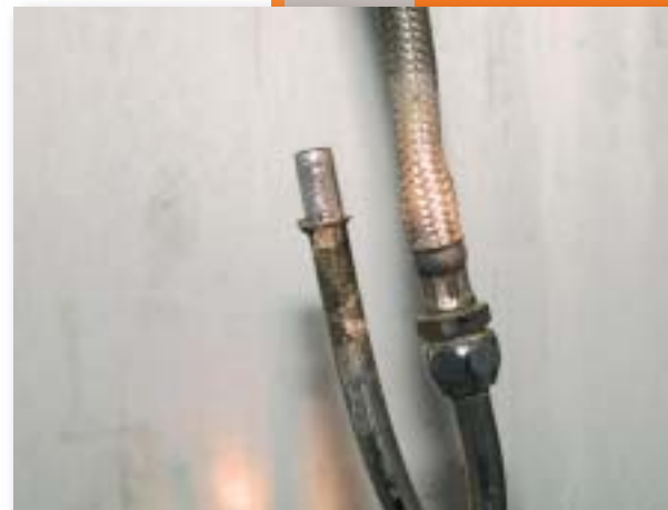
Bild 3 | Infolge der starken thermischen Belastung lösten sich die ursprünglich im Gehäuse der Mischbatterie eingelöteten Anschlussstücke. Dadurch kam es zum Austritt von Leitungswasser.
