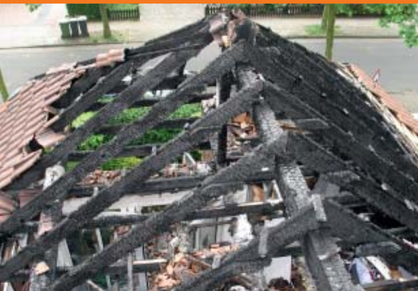
Bild 3 | Der Spitzboden brannte vollkommen aus.
