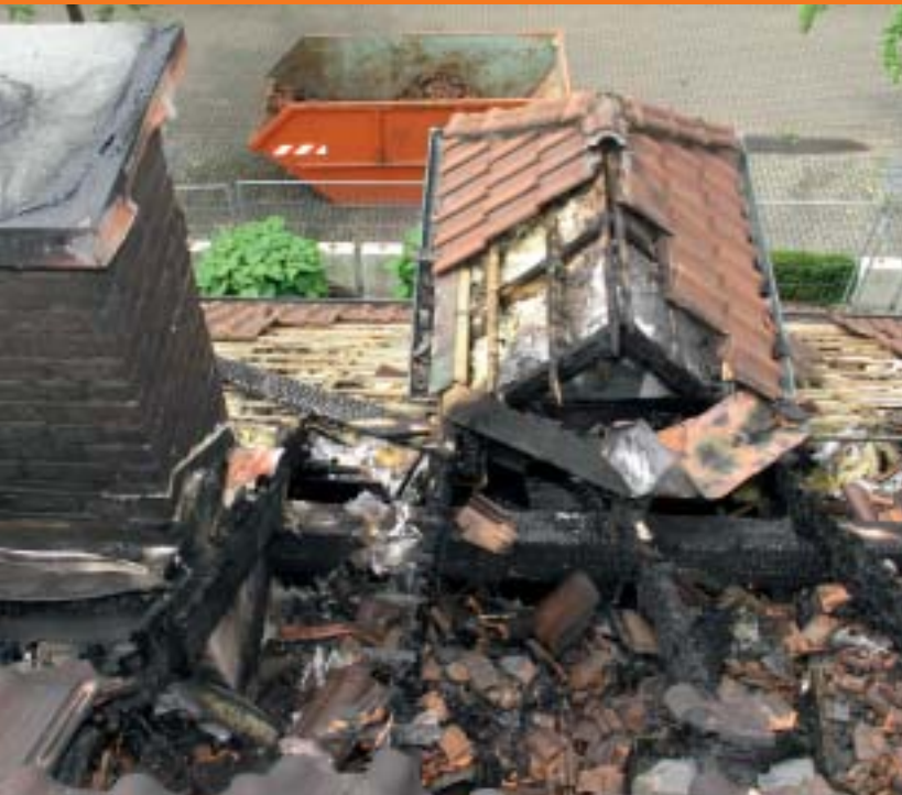
Bild 2 | Das Schadenobjekt aus einer anderen Perspektive
