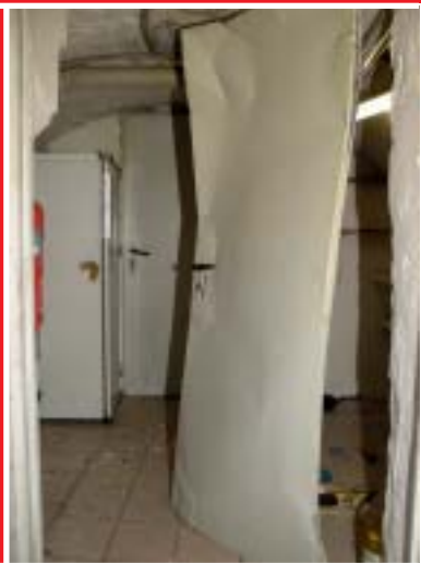
Bild 3 | Durch die Explosion wurde diese Tür herausgedrückt und deformiert.
