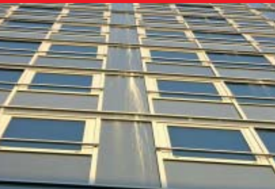
Bild 6 | Verätzung an der Fassade eines Bürogebäudes, Quelle: VdS 2021 (Eberhard Achenbach)
