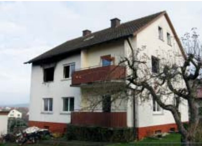
Bild 1 | Die Gebäudeansicht nach einem Wohnungsbrand. Das linke Fenster im Obergeschoss zeigt deutlich den Schwerpunkt des Feuers.
