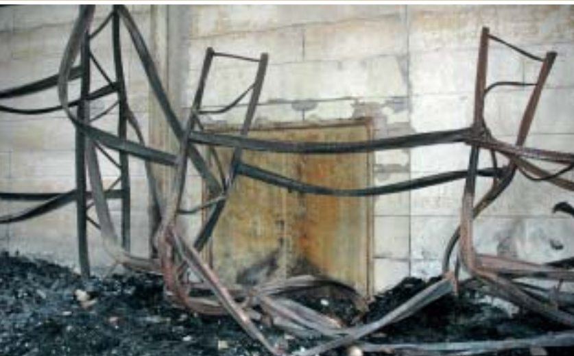
Bild 3 | Das Regal vor der Brandschutztür ist stark verformt
