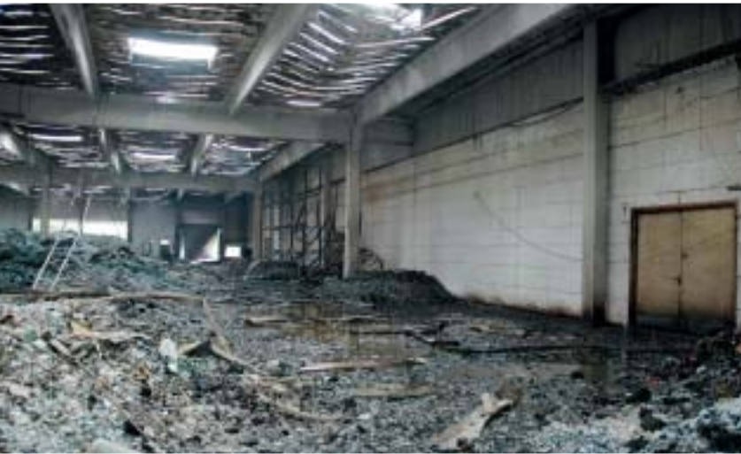
Bild 1 | Die ausgebrannte Halle
