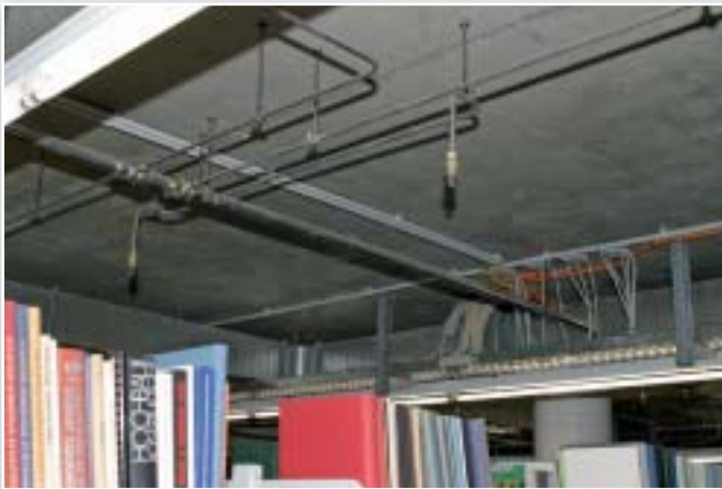
Bild 5 | Nur an wenigen Stellen sind die Leitungen der Hochdrucknebellöschanlage zu sehen. Im öffentlichen Bereich verschwinden sie hinter Deckenverkleidungen aus Lochblech. Nur die Düsen sind sichtbar.
