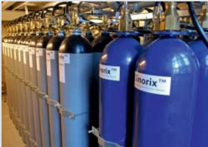
Bild 12 | Die Anordnung der Flaschenbatterien für die Sinorix-H 2 O-Gas-Löschanlagen: Im Hintergrund die Stickstoffflaschen, die nach einer Auslösung aus den blauen Wasserflaschen im Vordergrund das Wasser mit ausbringen. Für jede Anlage muss das Verhältnis von Stickstoff zu Wasser exakt geplant werden, damit die Ausströmraten und -zeiten aufeinander abgestimmt sind. (Foto: Siemens).
